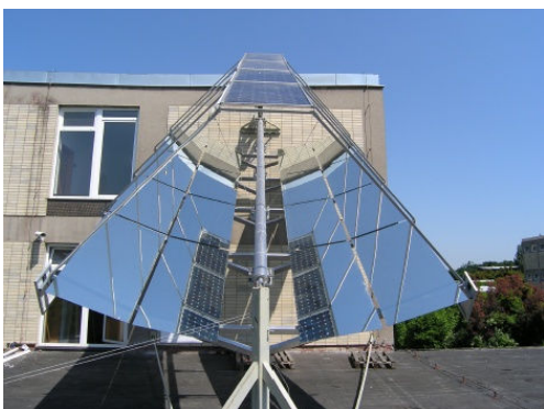
Fig 8. 1X bifacial PVT solar collector[9]
